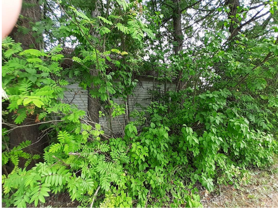
Kuva 14. Pielisentie 125. Rakennus edustaa vuosisadan alkuvuosikymmenien mökkirakentamista ja työläisasumisperinnettä. Tontti on vesakoitunut ja rakennus ei erotu ollenkaan. Tyhjillään ja ränsistynyt.
