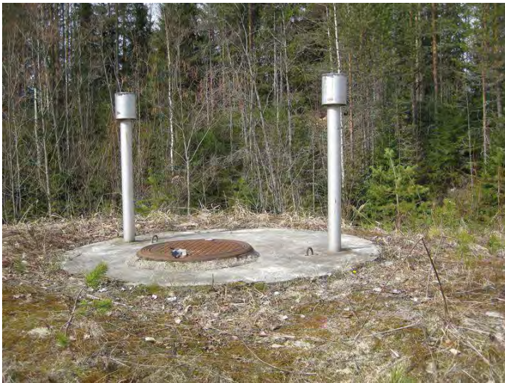
Kuva 2. Viekin vedenottamon siiviläputkikaivo.
