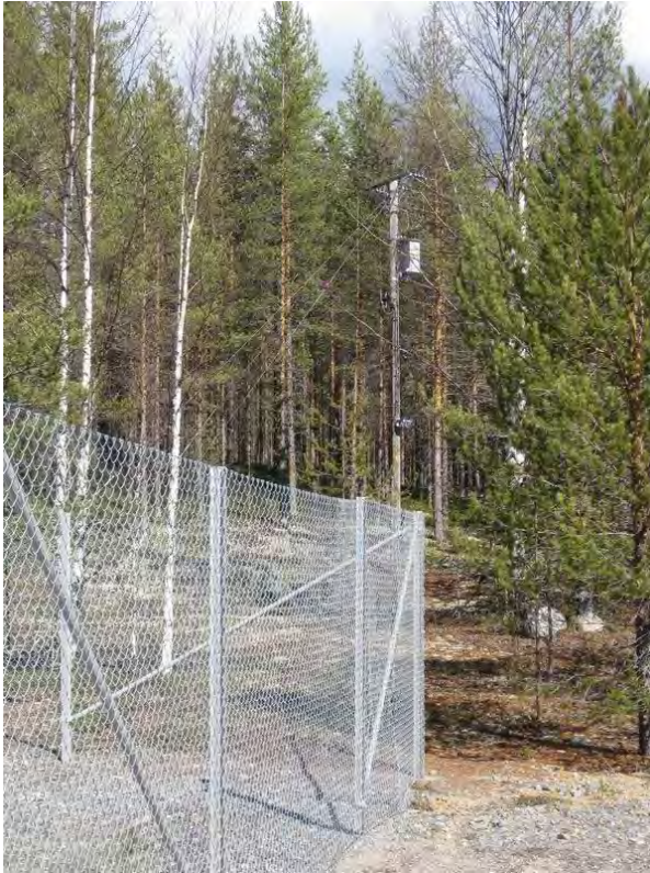
Kuva 8. Nälämön kuilukaivon vieressä sijaitseva pylväsmuuntamo saneerataan vuonna 2010 puistomuuntamoksi.
