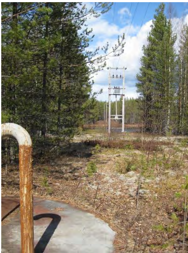
Kuva 7. Ruunaan kuilukaivon läheisyydessä sijaitseva pylväsmuuntamo.
