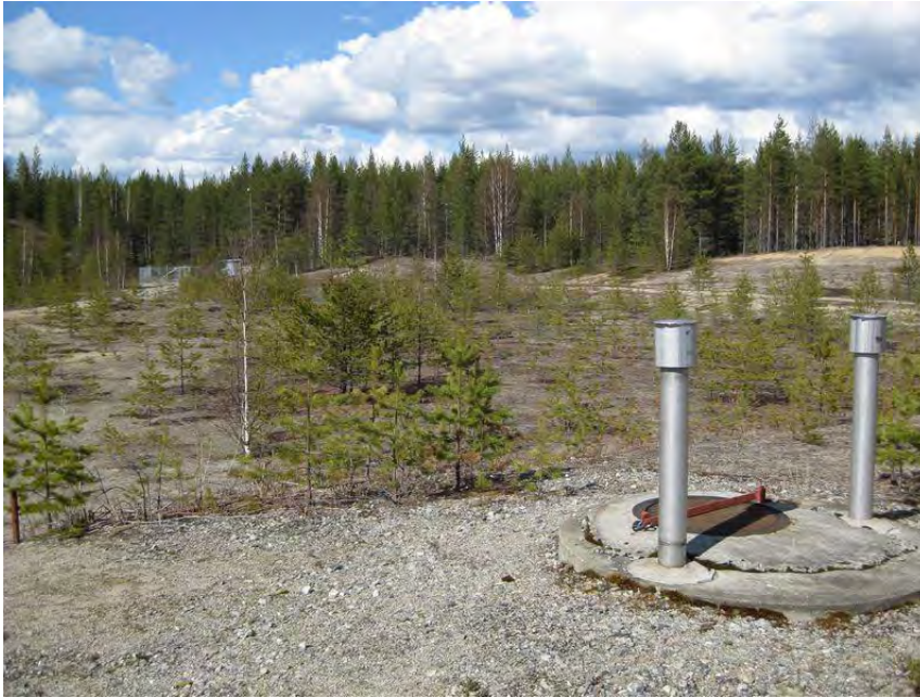
Kuva 2. Nälämön käytössä oleva siiviläputkikaivo.
