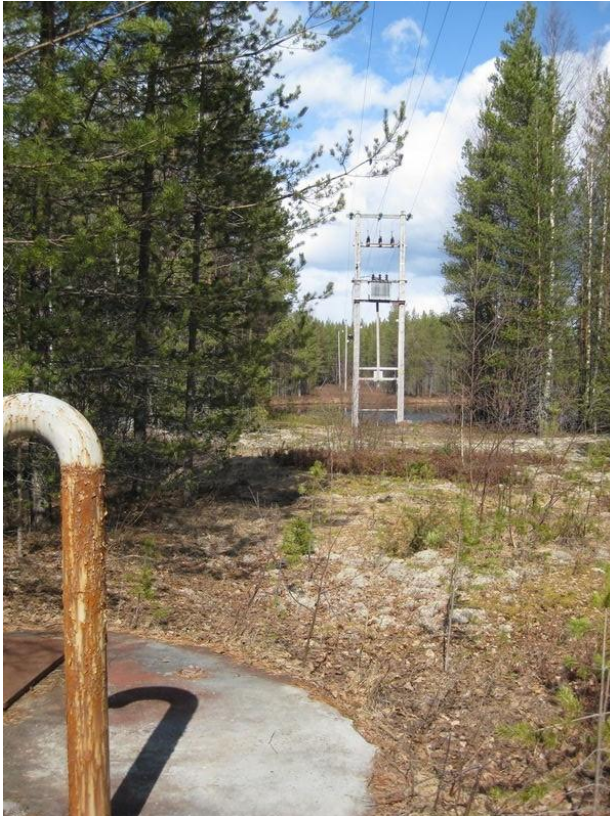
Kuva 7. Ruunaan kuilukaivon läheisyydessä sijaitseva pylväsmuuntamo.
