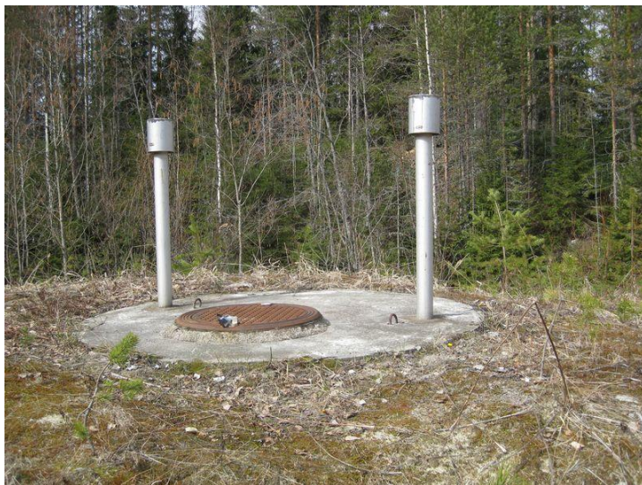
Kuva 2. Viekin vedenottamon siiviläputkikaivo.
