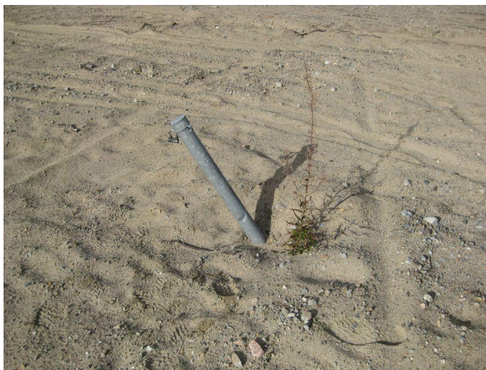
Kuva 7. Taipunut pohjaveden havaintoputki maa-ainesalueella.
