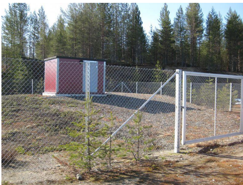
Kuva 2. Kokkokankaan vedenottamon siiviläputkikaivo nro 2.
